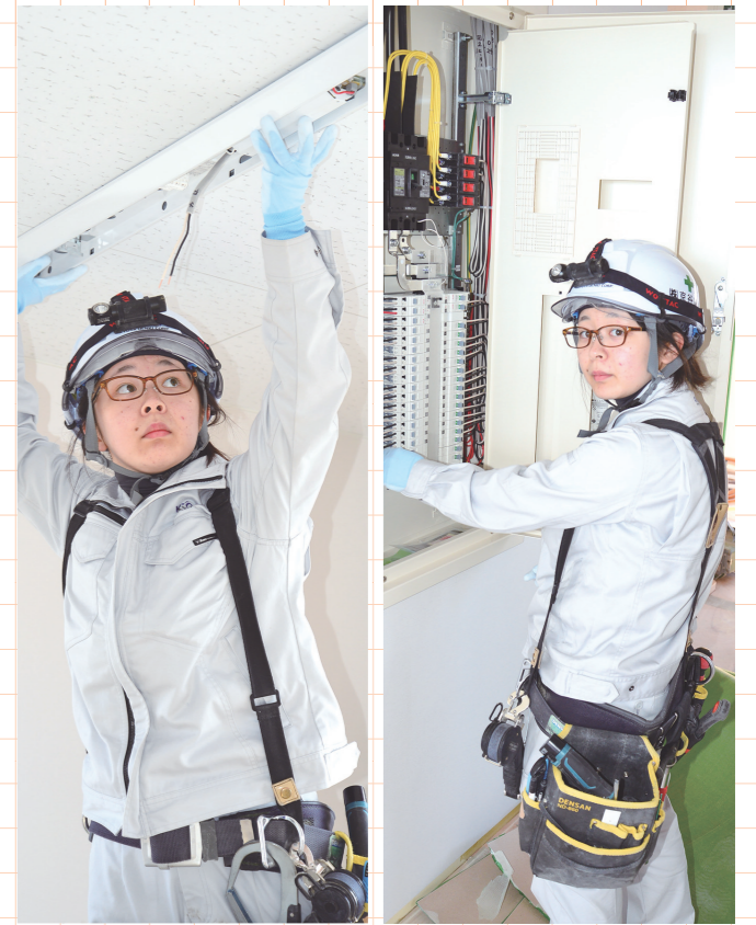
【写真左】小柄ながら、脚立を使って高さ2.7mの天井に照明器具を取り付ける下川さん【同右】分電盤の接続作業もすっかりお手の物
